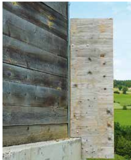
Schutz gegen Zugang zu ungesicherter Mauerkrone
