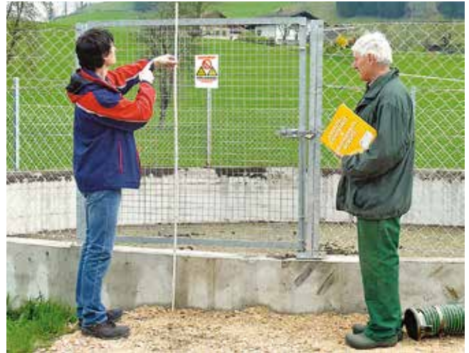
Offene Güllegrube mit 1,8 m hoher Umzäunung, Anfahrtschutz, Vorhängeschloss und Warntafel
