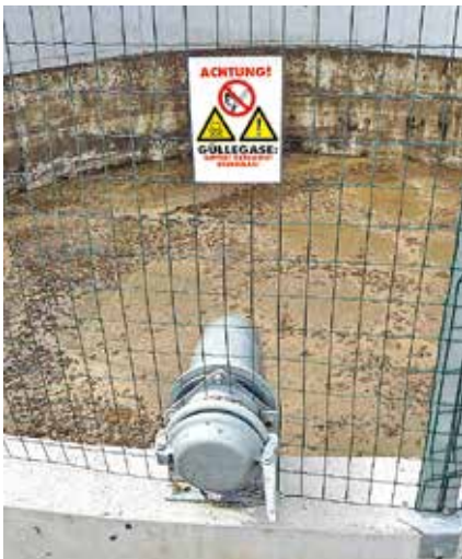
Grube mit fest montiertem Ansaugrohr und Warntafel
