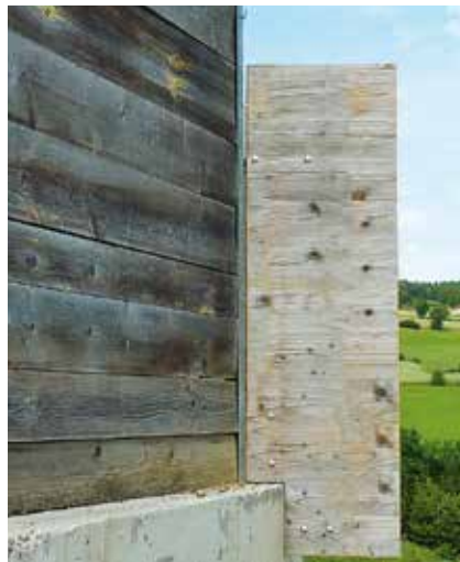
Schutz gegen Zugang zu ungesicherter Mauerkrone
