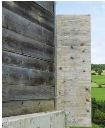
Schutz gegen Zugang zu ungesicherter Mauerkrone
