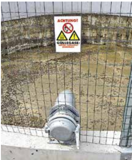
Grube mit fest montiertem Ansaugrohr und Warntafel
