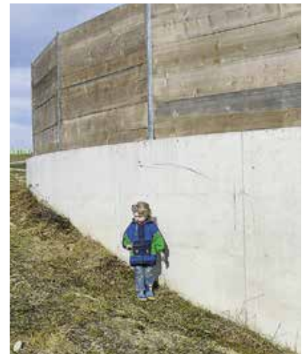
Vorbildliche kindersichere Güllegrube
